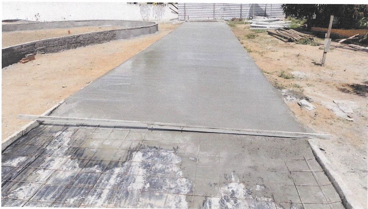
FOTO 28- EXECUÇÃO DE PASSEIO (CALÇADA) OU PISO DE CONCRETO COM CONCRETO MOLDADO IN LOCO, FEITO EM OBRA, ACABAMENTO CONVENCIONAL, ESPESSURA 6 CM
